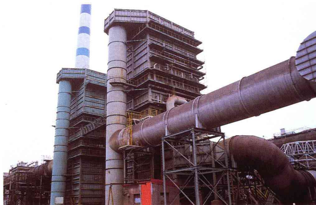
脱硫塔とアンモニア吸収塔。奥にそびえるのは高さ150mの大煙突だ
