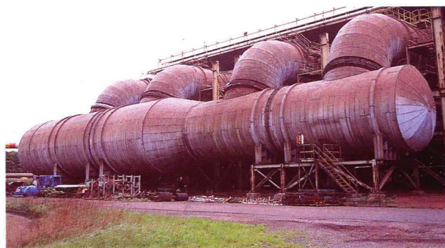
脱硝装置（触媒層）の大きなパイプの中には触媒となる鉄鉱石が入っている
