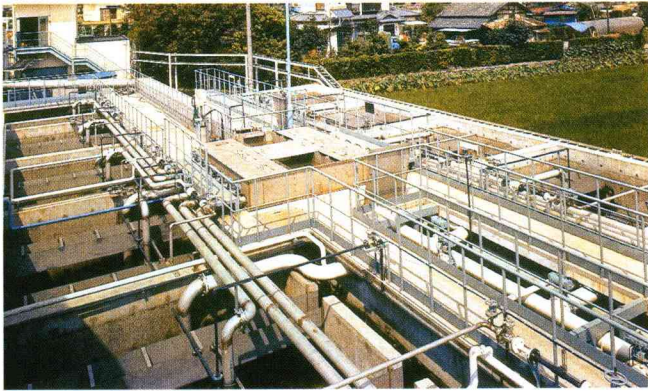
微生物を用いた生物膜ろ過装置
