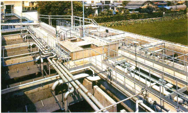
微生物を用いた生物膜ろ過装置
