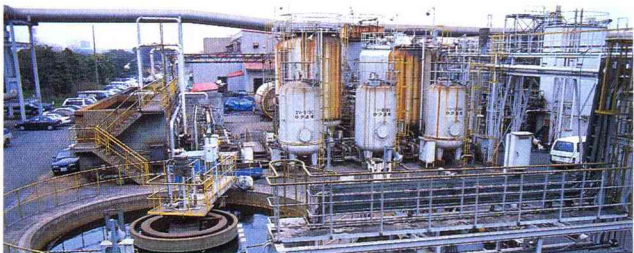
毎日大量の水を浄化する水処理設備
