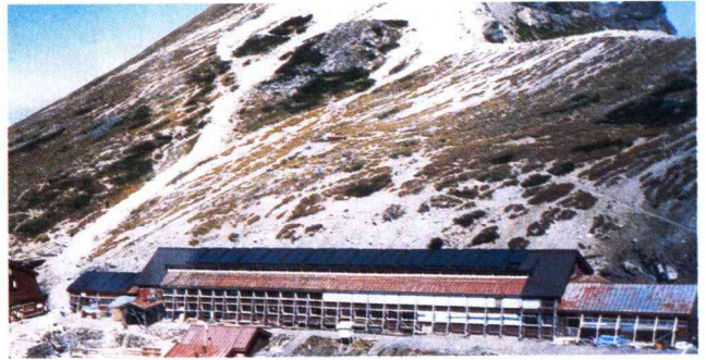
70kWの太陽電池に1kWの風力発電を組み合わせた山小屋用システム（白馬山荘）
