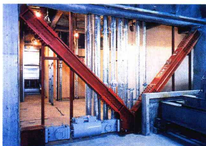
JALビルに用いられたパッシブ制震ダンパー
