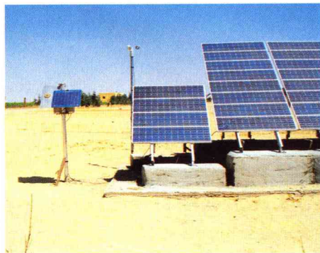
太陽電池を用いたドイツ製の地下水汲み上げ用ポンプ（エジプト）
