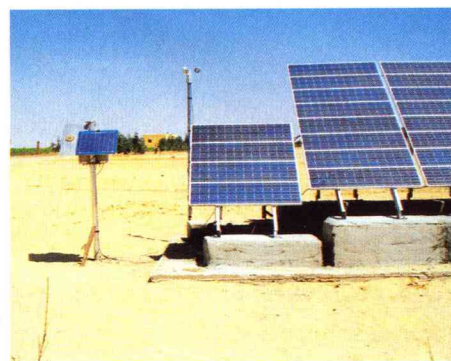
太陽電池を用いたドイツ製の地下水汲み上げ用ポンプ（エジプト）
