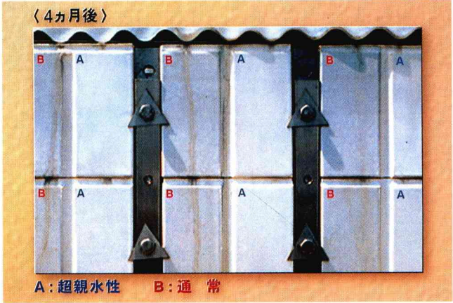
一定期間雨にさらしておいた光触媒タイルと通常タイル。ヨゴレに歴然とした差が出ていることが分かる
