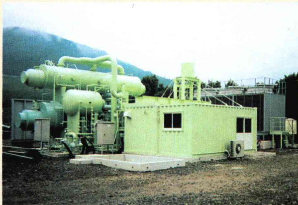
実証運転中の500kW級バイナリー発電システム
