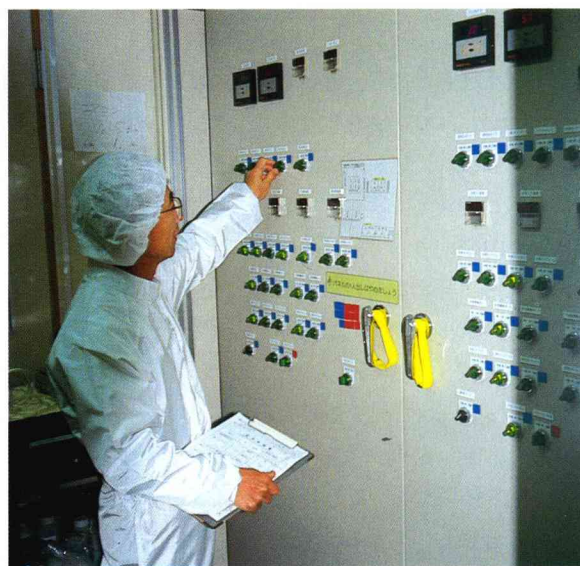
TSファームの制御室。
