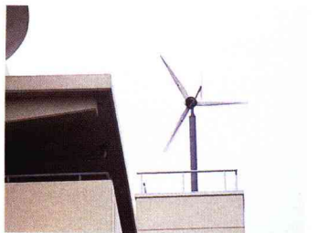
風を受けて回る風車。ビオトープの水循環の電力を供給する（深沢）。
