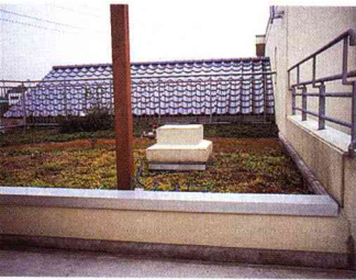
緑化された天井部分。温度上昇を抑える効果がある（深沢）。
