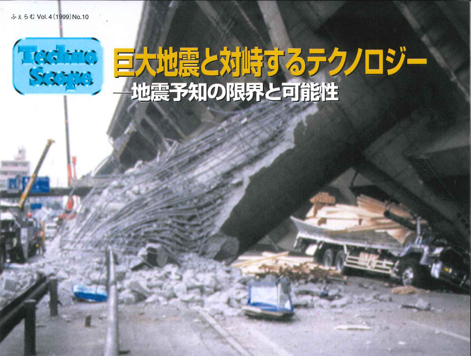
大震災で崩壊した阪神高速道路。
