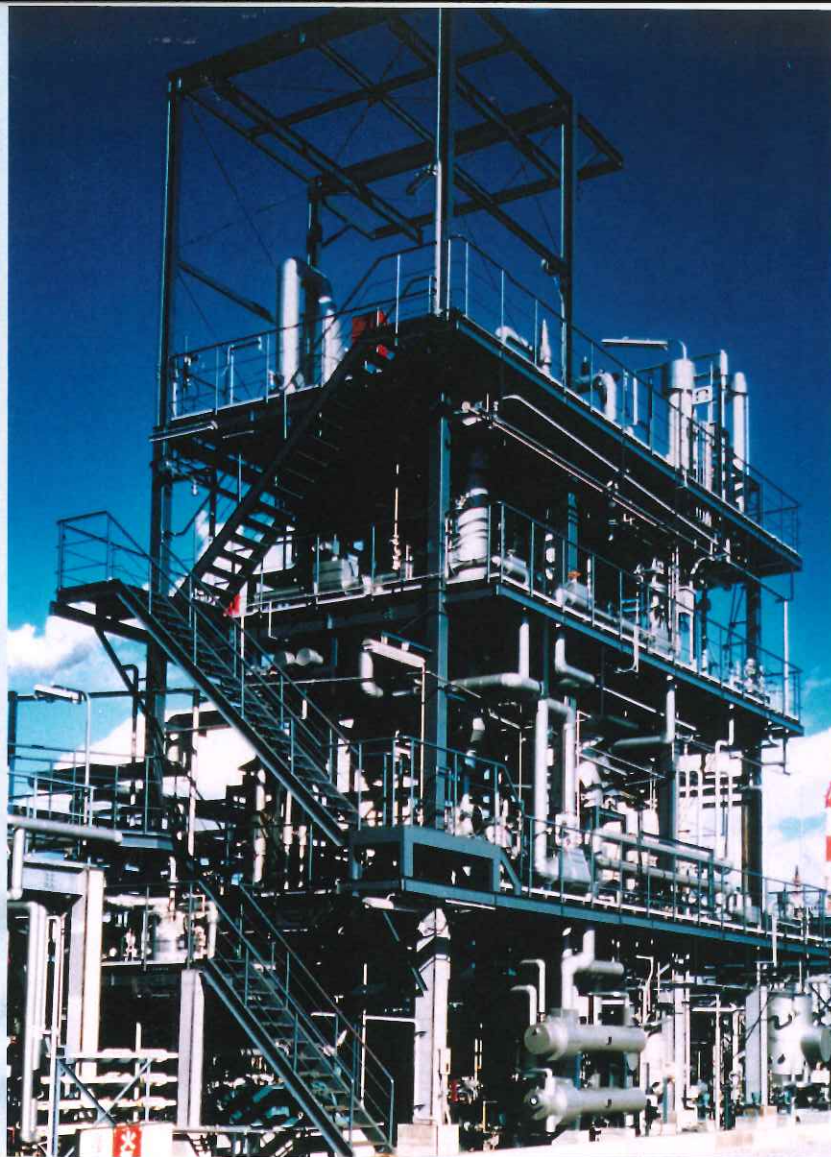
TDA回収プラント全景
