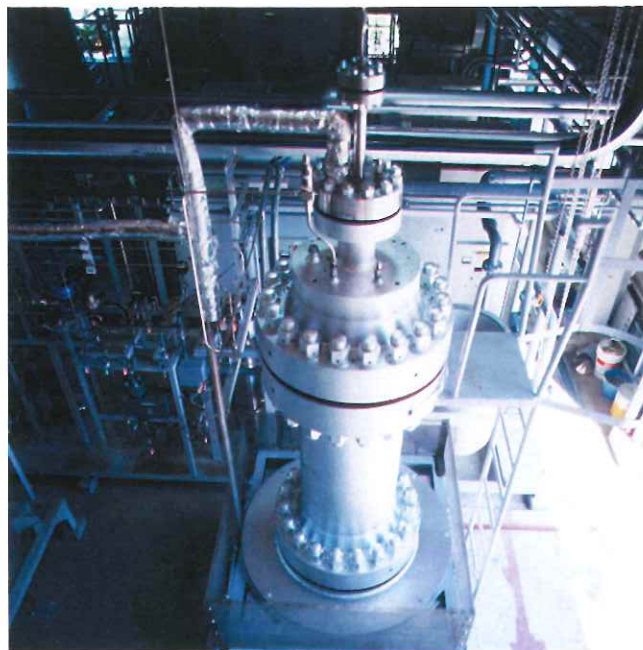
図6／工場廃液処理用臨界水酸化装置
