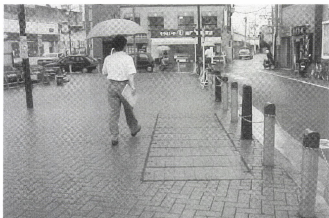
図16 喜多見駅前通りの地中化で道路下に設置したトランス
