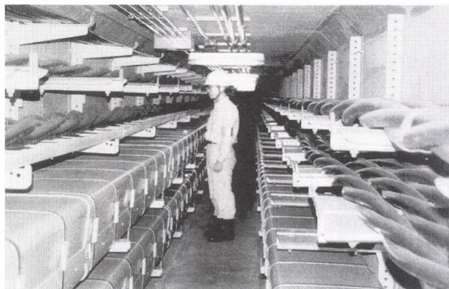
図5 青山幹線共同溝電力室内の27万5千V送電線
