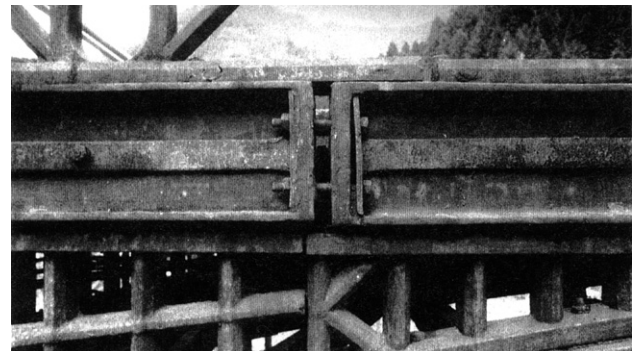
修理前 橋桁接合状況 橋桁同部材間接合部に隙間が空いている
