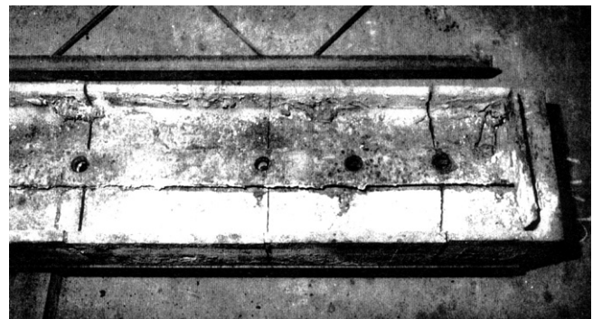
図4 橋桁の接合部と破断状況 3)
