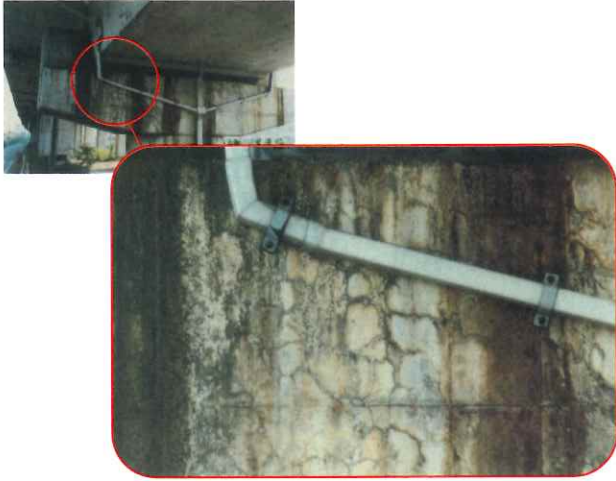
実際にコンクリートの剥落があった高架橋の橋脚
