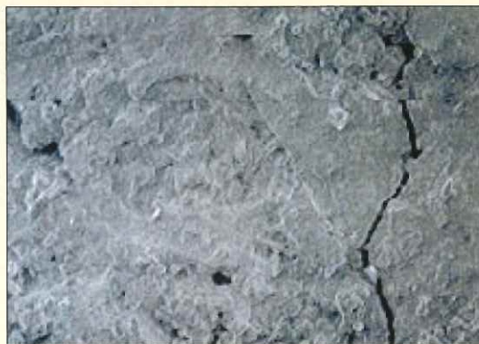
コンクリート組織内部の空隙
