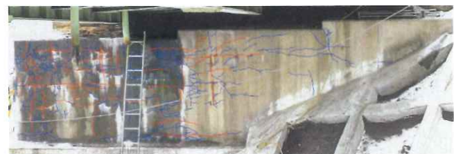
デジタルカメラを使用した画像診断システム例。赤い部分が0.2mm以上のひび、 青い部分がそれ以下のひびである。
