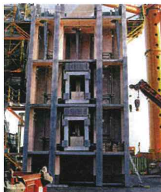
主塔内には20基の制振装置が設置された。
