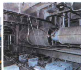
船体内部にはステンレス製のタービンシャフトが伸びている
