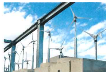
東京都心のビルで、小型の風力発電装置が設置された例(写真提供:ゼファー(株))
