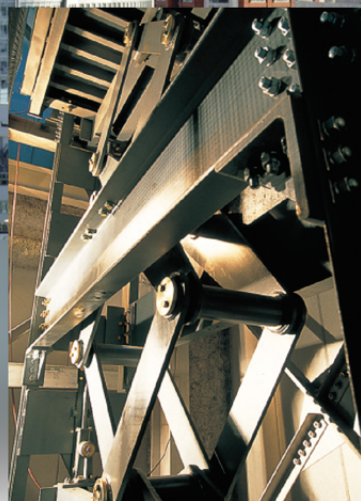
六本木ヒルズ(背景写真中央の高層ビル)で採用され話題を集めているダブルデッキ(2階建て)エレベータ「スカイウェイ」のかごの連結部。エレベータのかごを2階建てにしたもので、昇降路一本当りの輸送人数を大幅に増やせる。(写真提供:日本オーチス・エレベータ(株))
