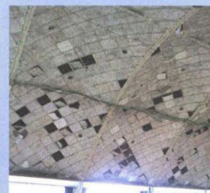
天井木毛セメント板落下
