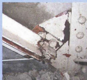
ブレース破断 (接合部)
