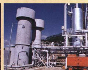
フラッシュタンク
