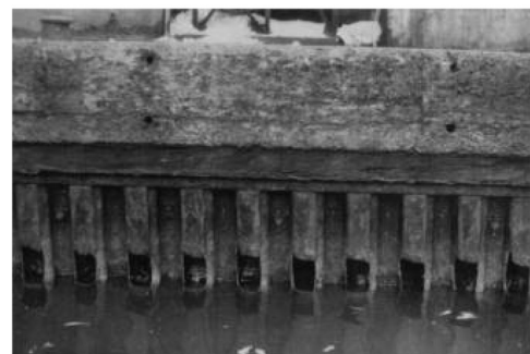
鋼矢板における集中腐食例
