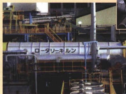
塩化ビニル処理装置 (JFEスチール(株) 東日本製鉄所(京浜) 構内)
