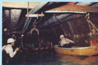
吉岡作業場で発生した出水は毎分85トンの水が押し寄せ、水没の危機に瀕した(昭和51年5月6日発生)。排水が終わったのが発生から2か月後、出水地点をう回して掘削し元の位置まで戻するのに約半年かかった。
