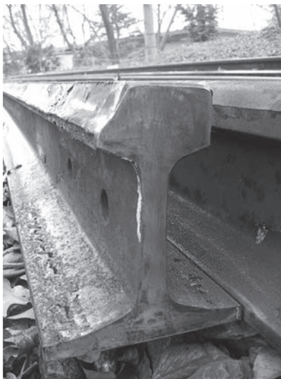
図12 外軌側摩耗の例
