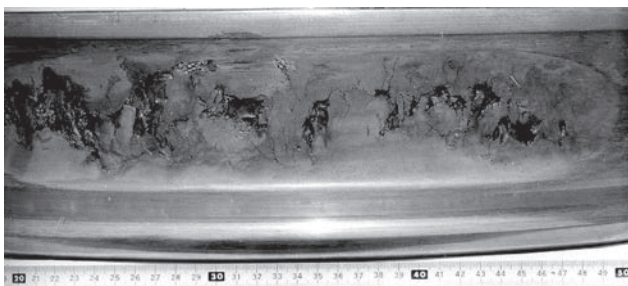
図3 フラットに起因するはく離
