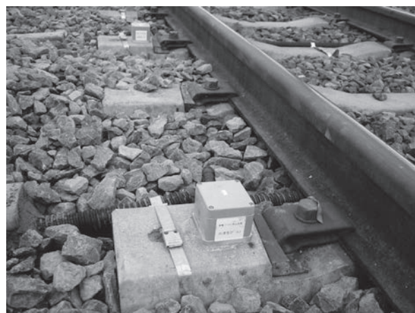
図7 線路脇に設置されたフラット検知装置
