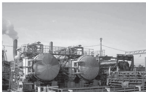
図 加圧式蒸気エージング設備概要
