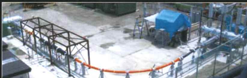
現在、日本で超伝導送電実証試験が進行している。超伝導ケーブルは温度変化などの影響を確認された後、実証試験に使用される。写真は確認試験のようす。(写真提供 住友電気工業(株))
