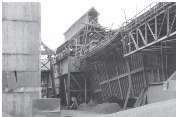
図4 地盤沈下により大きく破損した高炉原料槽(側面)
