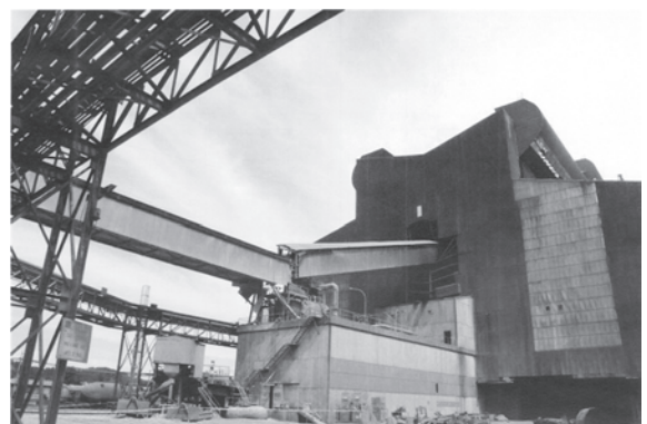
図2 装入コンベアが大きく破断した製鋼工場
