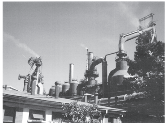
図1 炉頂ブリーダー・デッキが倒壊した第2高炉
