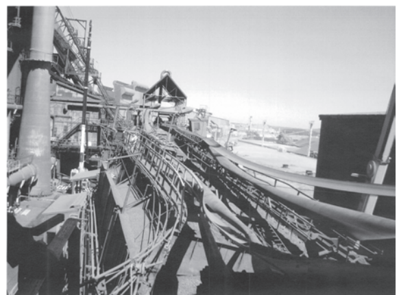
図3 地盤沈下により大きく破損した高炉原料槽(上面)
