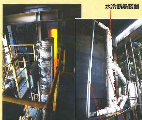
炭化室に診断装置が入るところ
