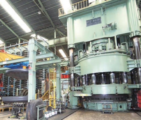
冷間6,000t複動油圧プレス機。プレス機の横には各サイズの金型が常備された立体倉庫があり、金型の取替え時間の短縮を図っている。
