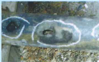
経年化・土壌腐食による孔食
