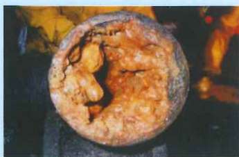
経年化による内面錆こび
