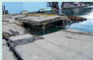
中央バースが亀裂、陥没。
