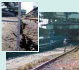
地盤変動により、石炭運搬用のレールが蛇行した
