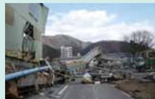
石炭搬送用パイプコンベアが崩壊。
