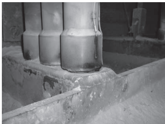
写真5 最終過熱器管缶前側荷重支持管天井貫通溶接部
