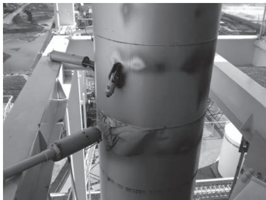
写真4 高温再熱蒸気管用防振器
