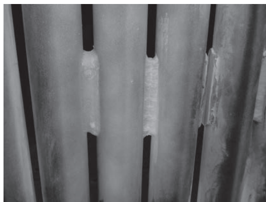
写真6 最終過熱器管タイロッド部
