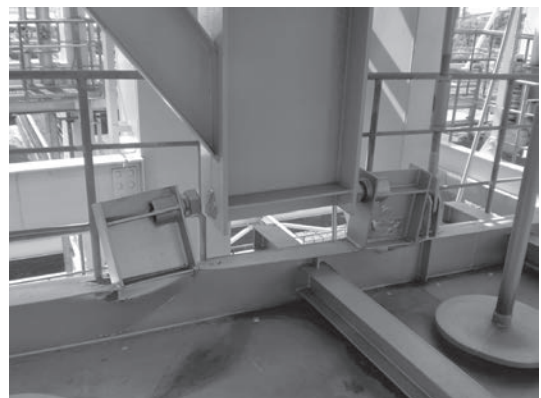
写真3 ボイラ地震受け金物
