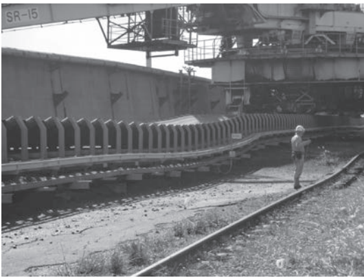
写真2 湾曲した石炭コンベア・SRレール
