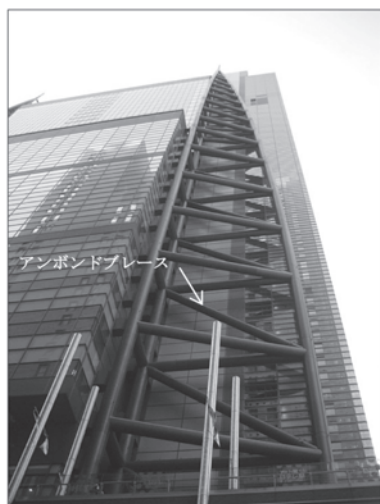
写真1 アンボンドブレース適用事例 (高層建築)
