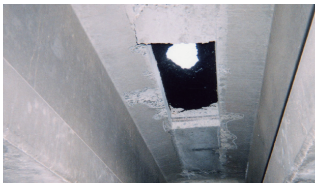
写真7 コンクリート部材の抜け落ち
