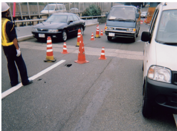
写真8 道路橋床版抜け落ちへの緊急交通規制対応状況
