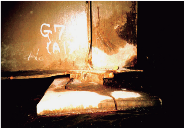
写真2 鋼部材の座屈
