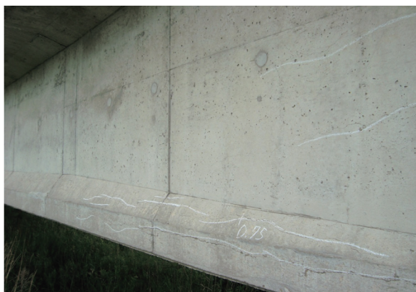
写真4 コンクリート部材のひび割れ
