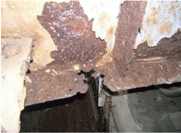
写真1 鋼部材の腐食
