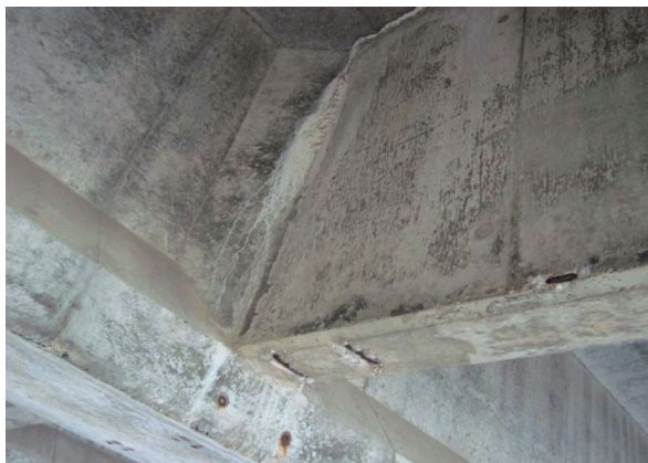
写真5 コンクリート部材の遊離石灰析出
