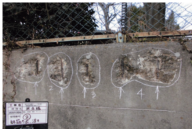
写真6 コンクリート部材のはく離
