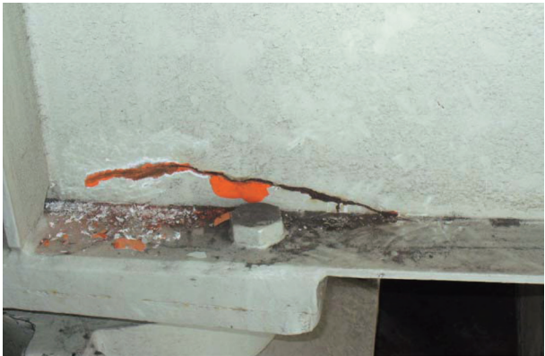
写真3 鋼部材の疲労き裂
