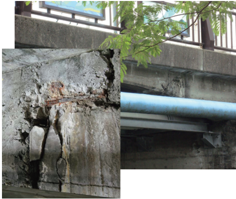
写真3 コンクリート橋ゲルバー部の変状（ひび割れ、鉄筋露出等損傷）
