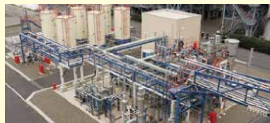
脱水素プラント(川崎市)
