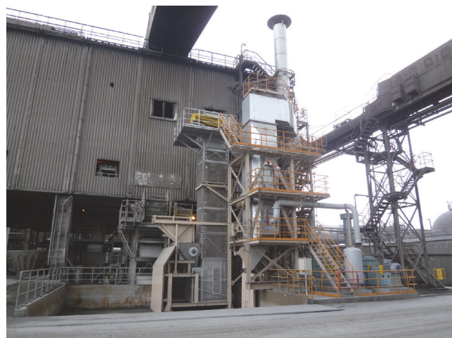
図2 スラグ熱回収設備の外観写真 6)
