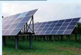
直流電流を供給する太陽光発電所
