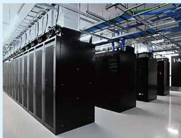
サーバー室の内部
