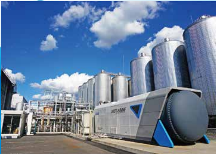
工場内に設置されたSOFCコージェネレーションシステム 画像提供: アサヒビール(株)
