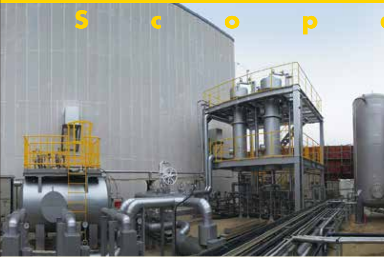
環境省委託事業「清掃工場から回収した二酸化炭素の資源化による炭素循環モデルの構築実証事業」として小田原市の環境事業センターに設置されたメタネーション実証設備は、毎時125 Nm 3 のメタン製造能力を持つ。なお、実証試験は2022年8月まで行われ、試験終了後、設備は解体予定である。画像提供：日立造船(株)
