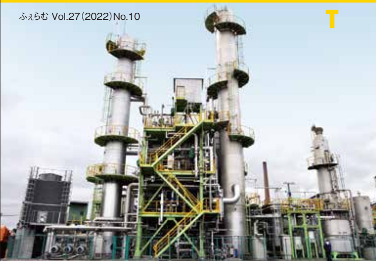
日本製鉄北日本製鉄所室蘭地区構内に設置された省エネ型CO 2 回収設備にはCOURSE50で開発された化学吸収液が採用されている。また、2号機が石炭火力発電所の燃焼排ガスからのCO 2 分離回収技術では日本初の商業設備に採用されている。 画像提供：日鉄エンジニアリング(株)
